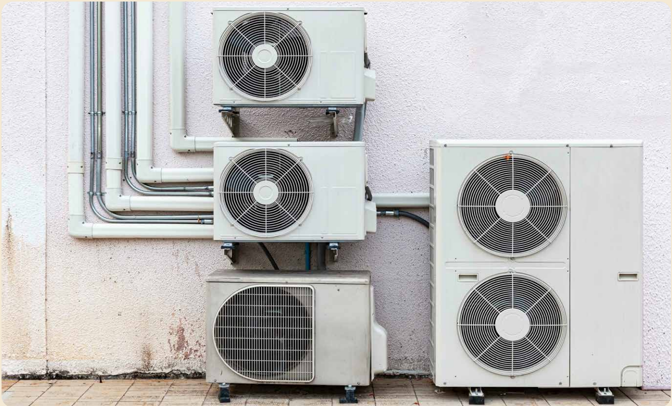
Außengerät des Klimaanlagekompressors, außerhalb eines Gebäudes installiert.
